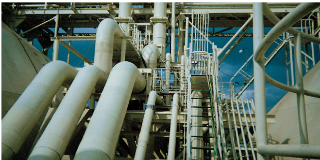
Moss Type LNG Carrier Pipe Insulation
